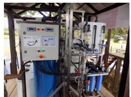
CUADRO ELÉCTRICO DE LA PLANTA
